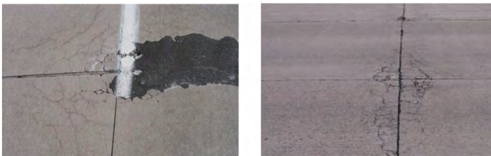
图 B. 1. 9 耐久性裂缝（中等）
