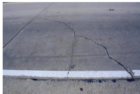
图 B.1.2-2 角隅断裂（中等）
