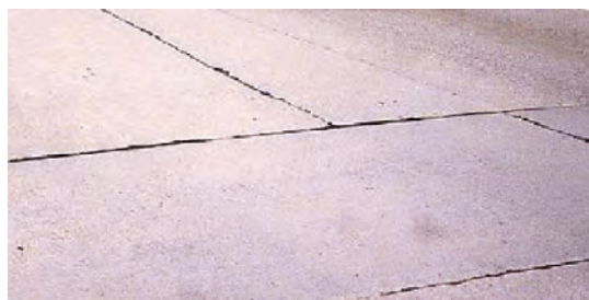
图 B.1.1-2 纵向、横向和斜向裂缝（中等）
