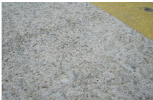
图 B.1.12 起皮、龟裂和细微裂纹
