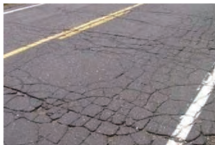
图 B.2.1-2 龟裂（严重）
