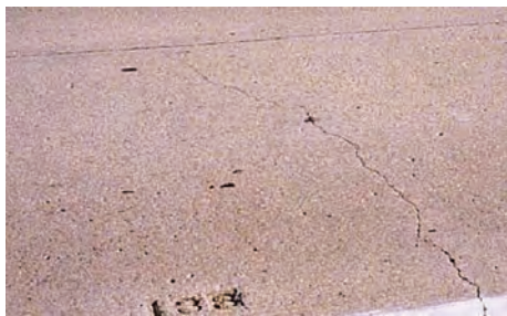
图 B.1.1-1 纵向、横向和斜向裂缝（轻微）
