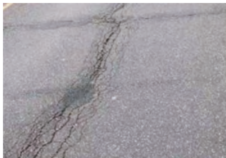
图 B. 2. 3-4 纵向裂缝 (严重)
