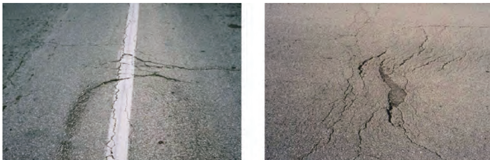
图 B. 2. 5 滑移裂缝
