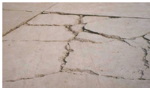
图 B. 1. 3-2 破碎板或交叉裂缝（严重）
