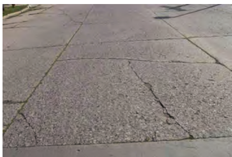
图 B. 1. 3-1 破碎板或交叉裂缝（中等）
