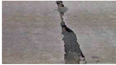
图 B. 1. 7-2 接缝破碎（严重）
