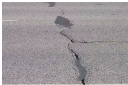
图 B. 2. 3-2 横向裂缝 (严重)
