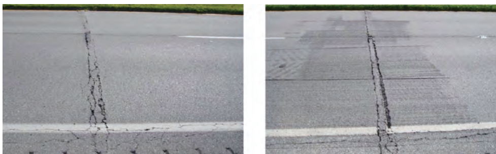
图 B. 2. 4 反射裂缝
