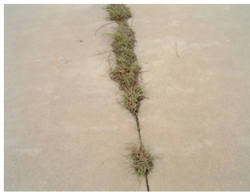
图 B. 1. 6-2 填缝料损坏（严重）
