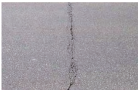
图 B. 2. 3-1 横向裂缝 (中等)
