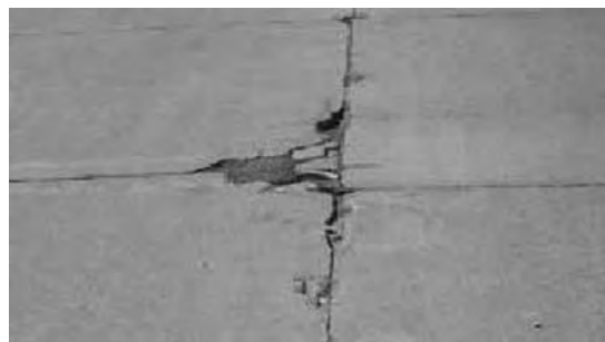
图 B.1.13-2 板角剥落（严重）
